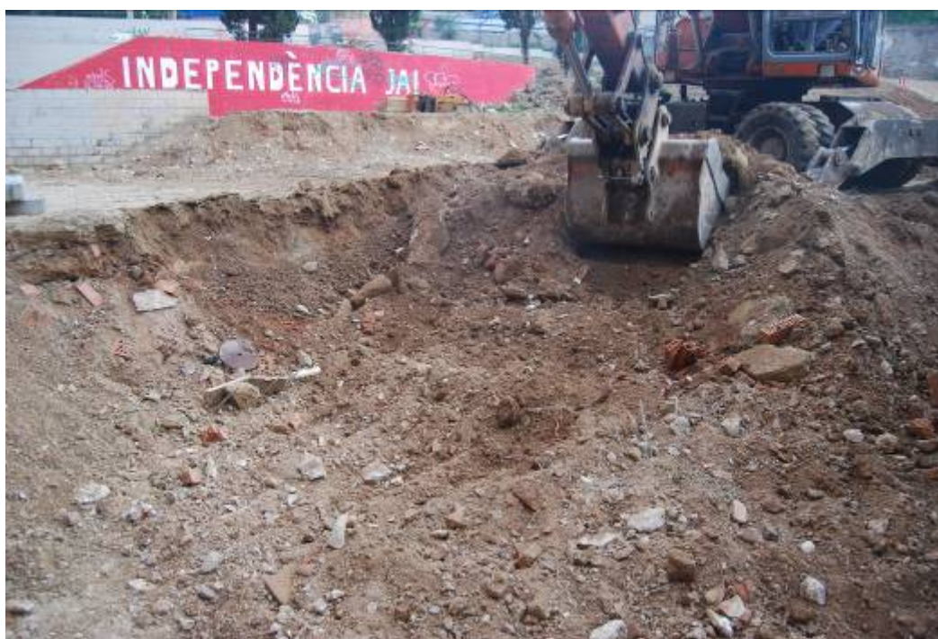
Fotografia núm. 22: sediments abocats a la plataforma inferior
